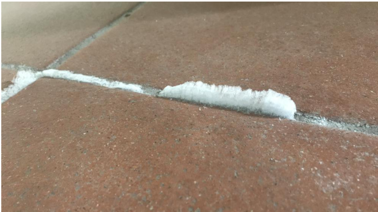
Abb. 4: Ausblühungen von Salzen auf den Fugen des Fußbodens der Kirche St. Vitus in Belum. Aufgrund der Austrocknung des Untergrundes blühen leicht lösliche Salze auf den porösen Fugen aus.
